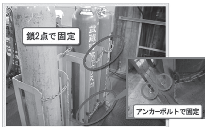
図 3－4－5. 高圧ガス容器の固定
