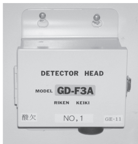
酸素センサー 壁に2カ所設置
