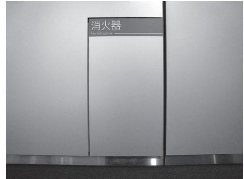
図1-4-1. 消火器の設置例
