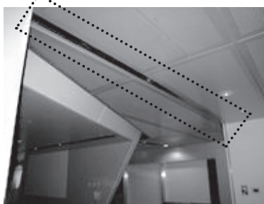
図1-4-6. 防火シャッター
