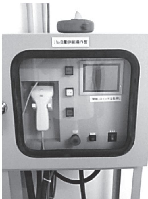
自動供給操作盤
