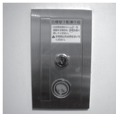
図1-4-9. 防煙垂れ壁の操作箱
