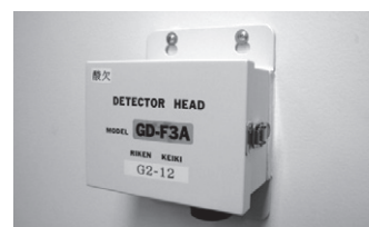
酸素濃度検知器
