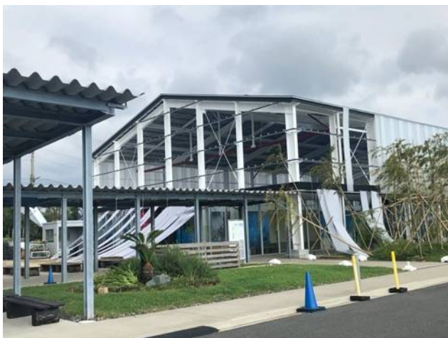
fig.5 被災した保田小学校体育館
