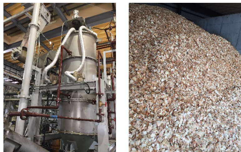
図4 中小規模木質バイオマスガス化発電の実測評価
