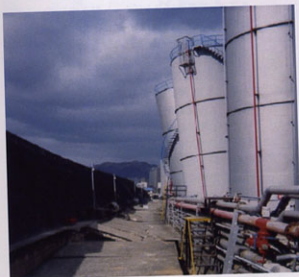
写真-1 液状化により傾斜したタンク (1995年 兵庫県南部地震)
