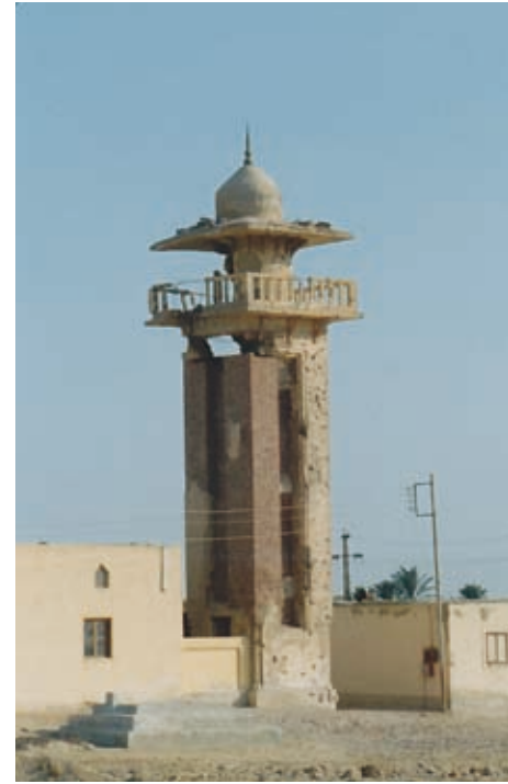
スエズ運河沿いの破壊されたモスクの尖塔
