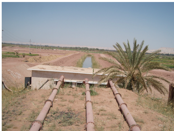
貯水池に排水をくみ上げるポンプ場のパイプ、ダブラ・オアシス
