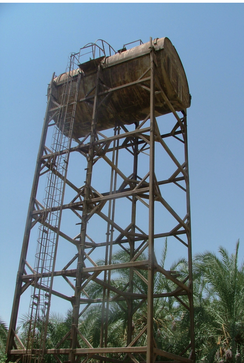
廃棄された貯水タンク、ハルガ・オアシス
